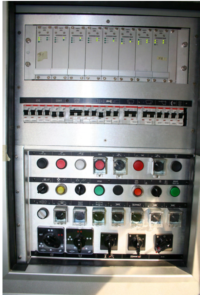
Abb. 10-3: Schaltschrank im Durchgang zum Führerraum
